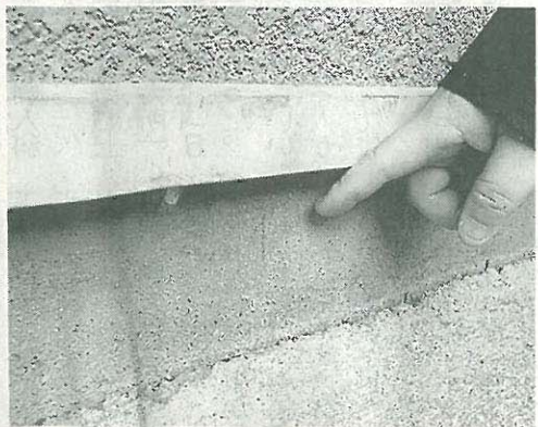
基礎にわずかなひび。問題ないレベルという
