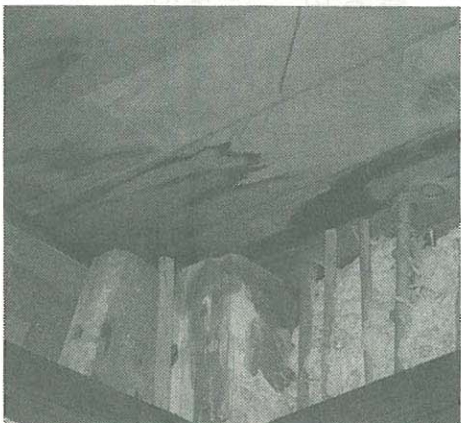
③気づいていないだけで、屋根裏で雨漏りしている例も
